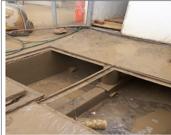
Foto 1. Sistema ineficiente para la sedimentación de lodos procedente de la actividad de lavado de vehículos.
