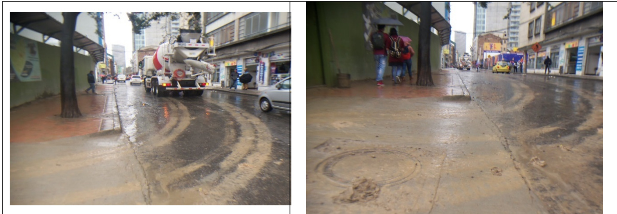
Fotos 14 y 15. No se ejerce control riguroso a la limpieza adecuada de los vehículos relacionados con el proceso constructivo previa evacuación del predio.
