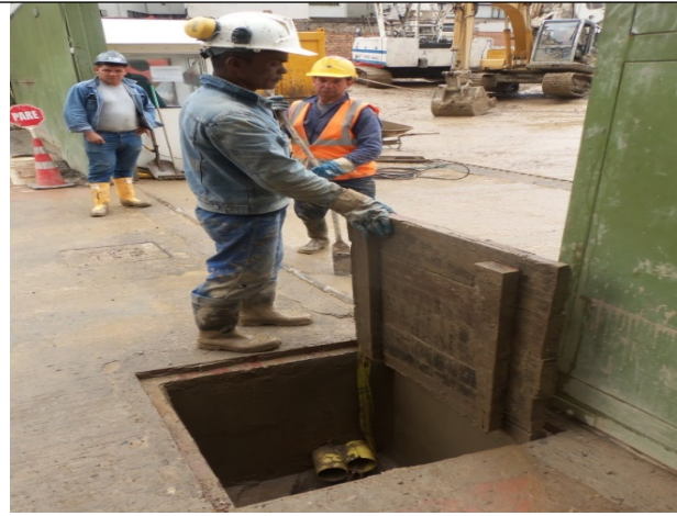
Foto 2. Evidencia del vertimiento de agua con carga de sedimentos a la caja de inspección ubicada en el espacio público junto al acceso sur de la Carrera 5 No. 21 – 38.
