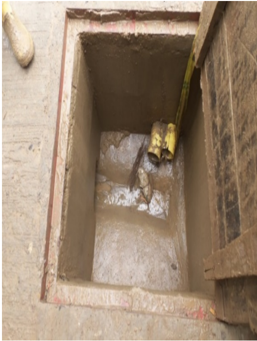
Foto 4. Caja de inspección ubicada en el espacio público junto al acceso sur de la Carrera 5 No. 21 – 38.
