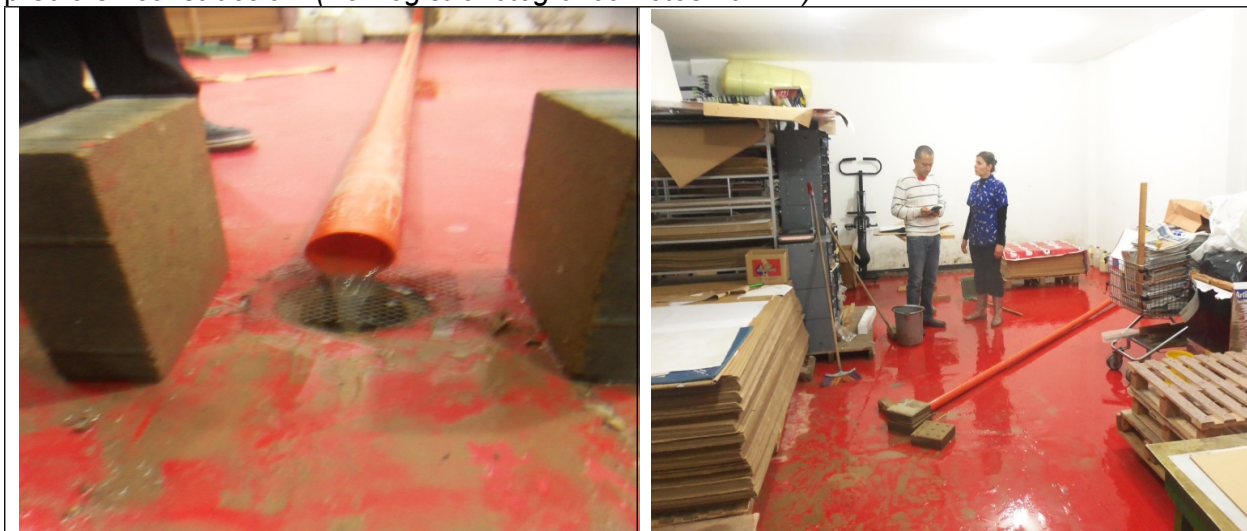
Fotos 10 y 11. Se evidenció el vertimiento directo de agua con sedimentos disueltos a sistema de drenaje de la papelería ARCA.
