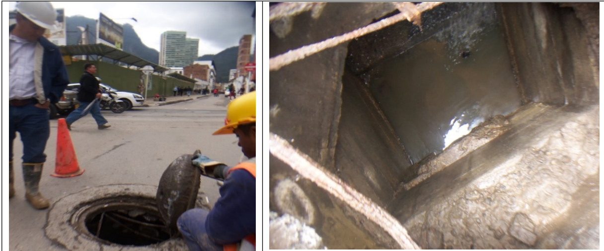
Foto 8 y 9. Se evidenció el vertimiento de agua con sedimentos disueltos a los componentes del sistema de drenaje urbano. Pozo de inspección ubicado en la calle 21 con carrera 5.
